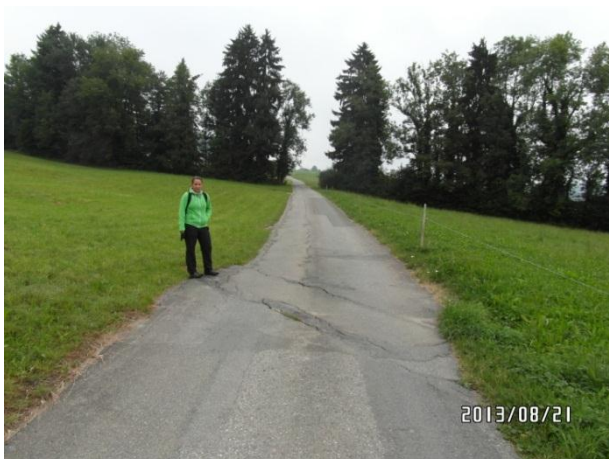
Abb. 7: Die markanten Verschiebungen und Risse in der Straße sind ein deutlicher Indikator, daß hier ein Scherrand der Rutschung verläuft.
