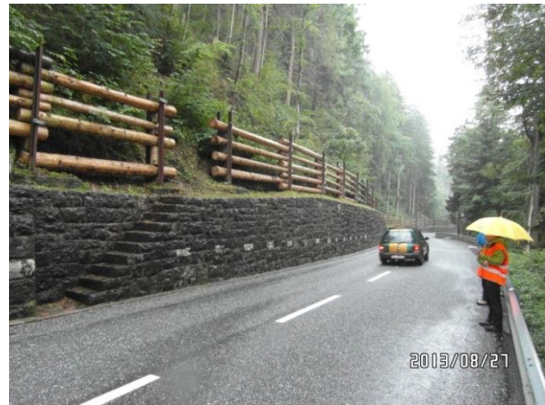
Abb.3: Holzpalisade zum Steinschlagschutz
