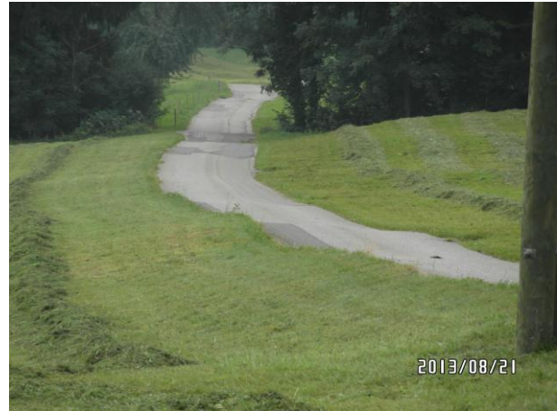
Abb. 6: Eine Straße im Rutschgebiet ist stark wellig.
