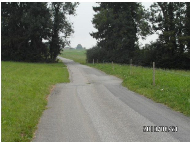
Permanente Rutschung Roteflue mit differentiellen Bewegungen.
