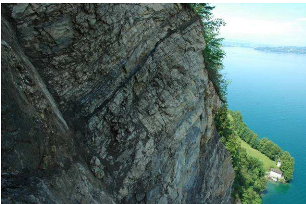
Visuelle Kontrolle von bestehenden Rissen. Im Hintergrund ist die Luzerner Bucht.
