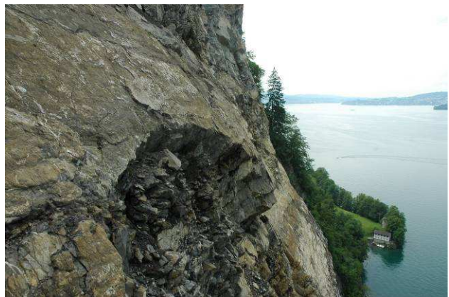
Frische Felsausbruchsstelle im zentralen Wandbereich, Blick in Richtung Westen (Luzern)
