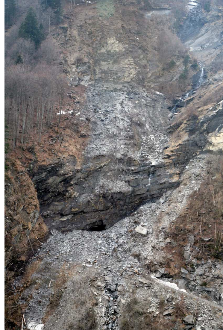
17. April 2012 wurde das Eingangsportal zum Stollen durch den prognostizierten Felssturz vollständig verschüttet.
