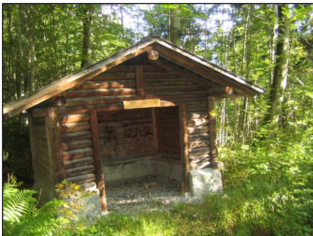
In der riesigen Permanent-rutschung oberhalb Gasenzen steht die Wanderhütte im Gebiet Dimmerüti schief
