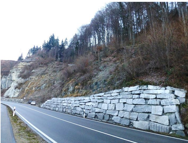
Situation vor Beginn der Sanierungsmassnahmen im Jahr 2014.
