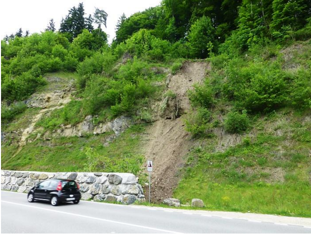
Die Hangmure vom Juni 2013 wurde von dem 2007 erstellten Steinschlagschutzdamm erfolgreich zurückgehalten, beschädigte jedoch Teile der Erosionsschutznetze.
